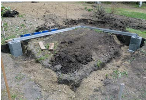
Unter anderem gruben die Bauherren einen Ring unter das Fundament des Gewächshauses, in das sie Kies füllten, um Niederschlag optimal von dem abschüssigen Gelände abzuführen. (Foto: WAMA/Heinz)
